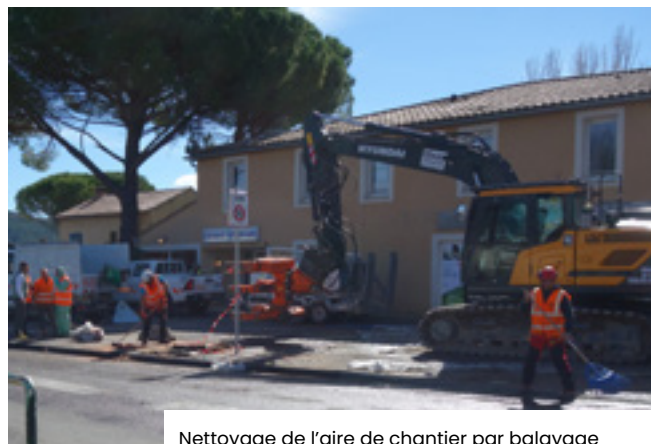
Nettoyage de l'aire de chantier par balayage et ramassage des bâches, Vaison-la-Romaine, mars 2023 | © Plante & Cité / Marine de Bodard
