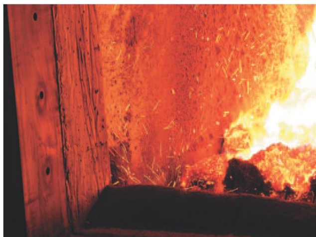
Chaufferie bois d'Athis-Mons (Essonne)
