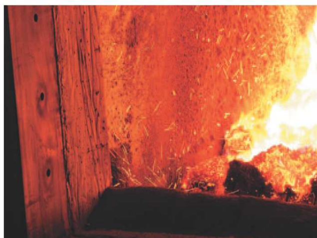
Chaufferie bois d'Athis-Mons (Essonne)
