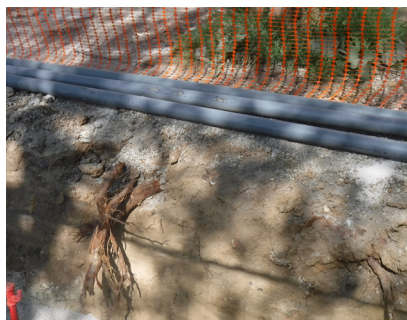
Racines exposées au chancre suite à des travaux (photo DRIAAF-SRAL)
