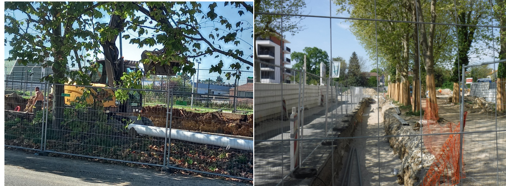
Les chantiers de travaux publics, un risque majeur de blessures pour les platanes (photo DRIAAF-SRAL)
